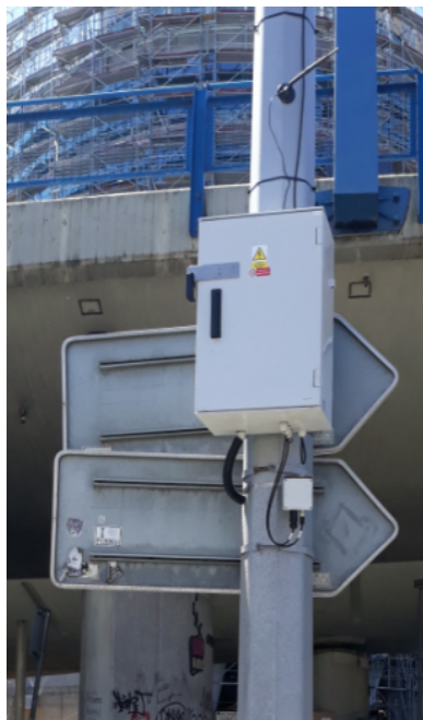
Obrázek 4. Detail umístění cyklosčítače na sloupu VO
